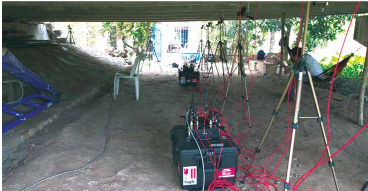
Lắp đặt thiết bị đo, thu số liệu tự động bằng Wifi
